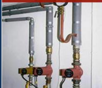
Instalacje CO i CWU
